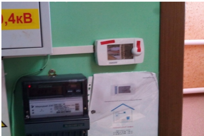
Рис. 6. Установленные термоконтроллеры в НГДУ «Азнакаевскнефть»
