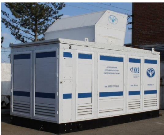
Рис. 6. АГНКС контейнерного исполнения
