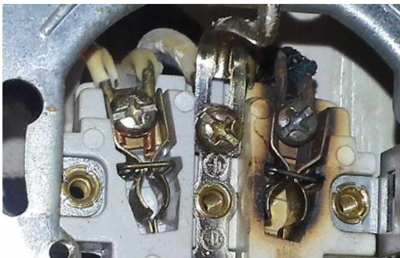
Рис. 2. Последствия плохого контакта в розетке
